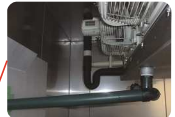
▲ 排水においても万が一の可燃性を考慮し、耐火性塩ビを採用しています。
